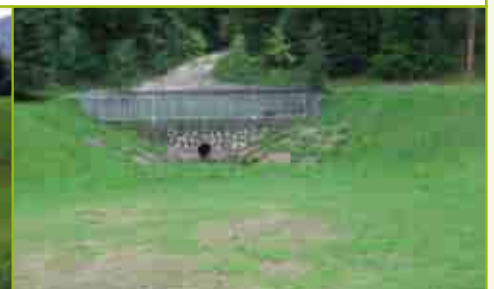
Beckenversickerung in Oberplanitzing, Kaltern
