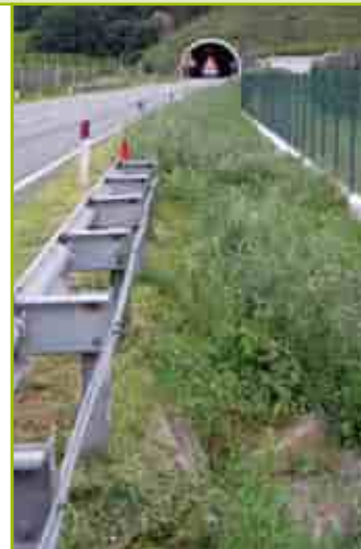
Mulden- und Rigolenversickerung bei der Umfahrungsstraße St. Jakob
